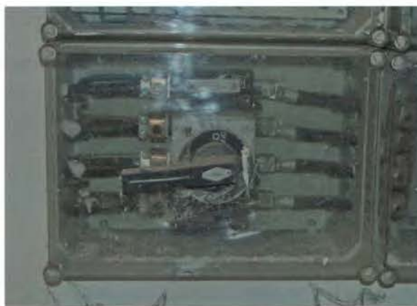
Figura 6.27. Interruptor General de Maniobra (IGM).
