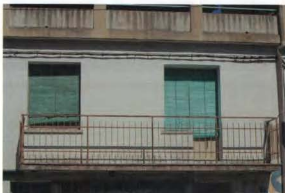
Figura 3.18. Ejecución de una red posada alrededor de una ventana y la puerta de un balcón. A simple vista no está claro si se ha respetado la distancia mínima de 30 cm a la parte superior de las aberturas.
