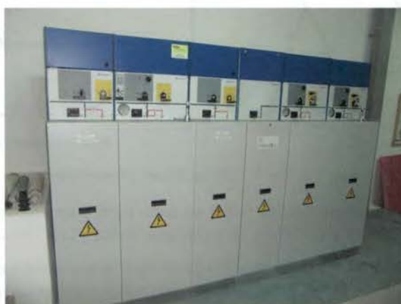
Figura 2.1. Aspecto interior de un CT con celdas modulares de corte en SF 6 .
