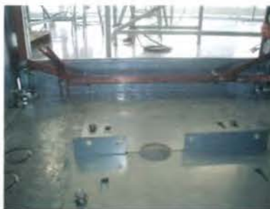
Figura 2.57. Conexión entre celdas de la pat de protección en un CT de abonado con fines didácticos.
