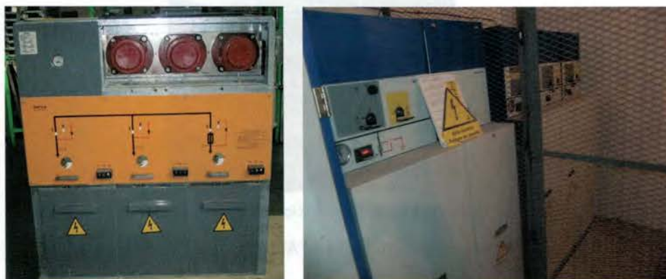
Figura 2.31. Celdas compactas y modulares de corte en \text{SF}_6 .
