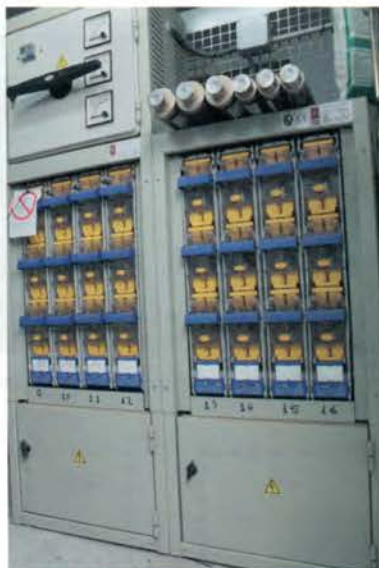
Figura 2.25. Cuadro de BT de un CT de interior.
