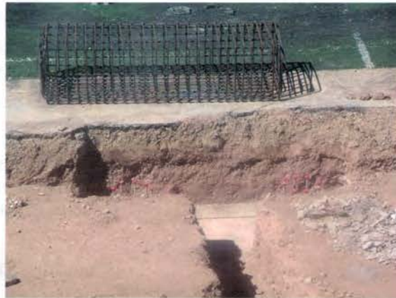
Figura 6.48. Electrodo de puesta a tierra enterrado todo el perímetro del edificio a una profundidad mínima de 50 cm.
