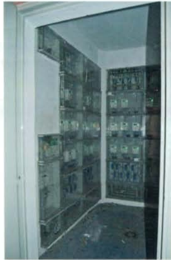
Figura 6.34. Cuarto para la centralización de contadores.
