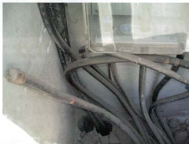
Figura 5.4. Detalle de la entrada en el nicho de una CGP de la acometida subterránea.
