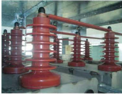
Figura 2.51. Conexiones en las celdas de línea de un CT de abonado con fines didácticos.
