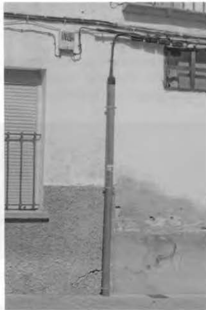
Figura 3.10. Tubo de protección preceptivo de una línea aérea posada empleado cuando se rebasa la distancia mínima al suelo de 2,5 m.
