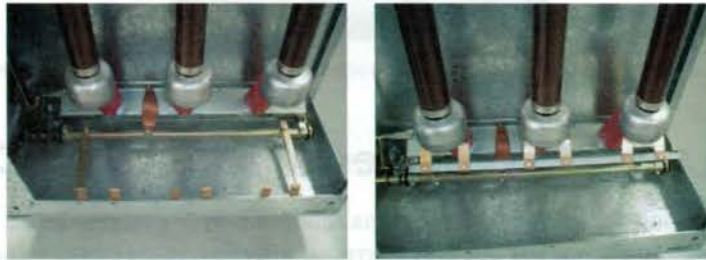
Figura 2.54. Estados del seccionador de pat (celda de protección) de un CT de abonado con fines didácticos.
