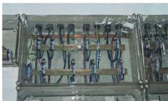
Figura 6.33. Unidad funcional de embarrado de protección y bornes de salida.
