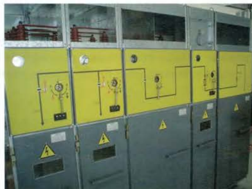
Figura 2.49. Aspecto final del montaje de un CT de abonado con fines didácticos.
