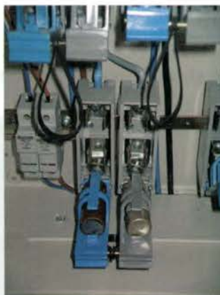
Figura 6.35. Fotografía de base portafusibles para DI donde se aprecia tanto el cartucho fusible como el cilindro que da continuidad al neutro.
