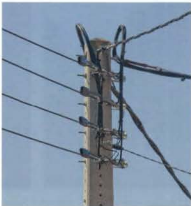
Figura 3.4. Conductores desnudos en la parte izquierda del apoyo y aislados en la derecha.
