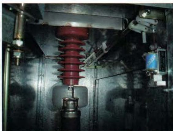
Figura 2.19. Fusible APR en celda de protección.
