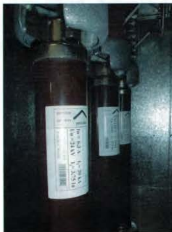
Figura 2.53. Detalle de la posición del percutor del fusible APR montado en celda de protección.
