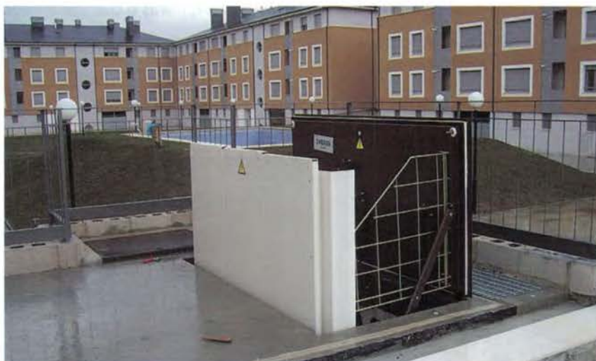
Figura 2.7. CT prefabricado subterráneo horizontal.
