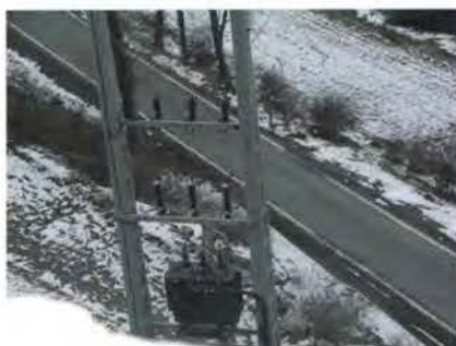
Figura 2.24. Pararrayos autoválvulas en un CT de intemperie en apoyo de hormigón.
