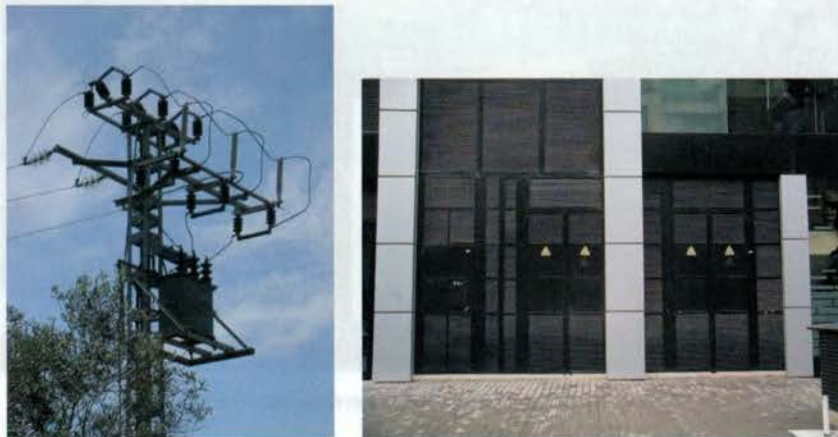
Figura 2.5. CT de intemperie y CT de interior.
