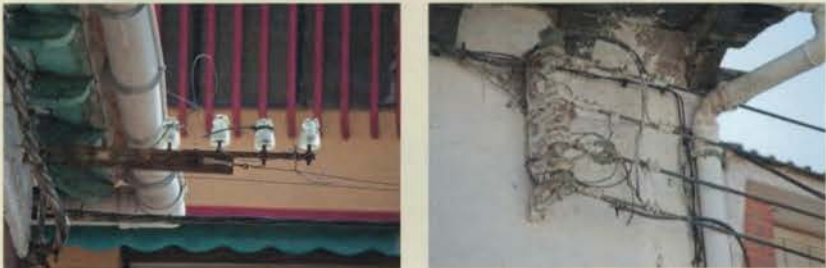
Figura 3.5. A la izquierda, restos de una red eléctrica de baja tensión con conductores desnudos que discurría próxima a la fachada. A la derecha, red de cables aislados que aprovechan la infraestructura de una antigua red de cables desnudos.
