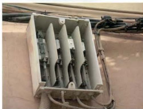
Caja General de Protección en montaje superficial
