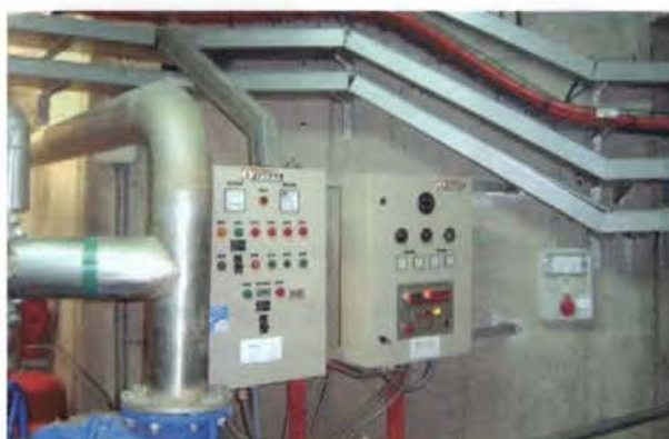
Figura 4.13. Sistema de bombas de achique de agua de una galería visitable.
