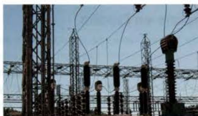
Subestación de transporte
