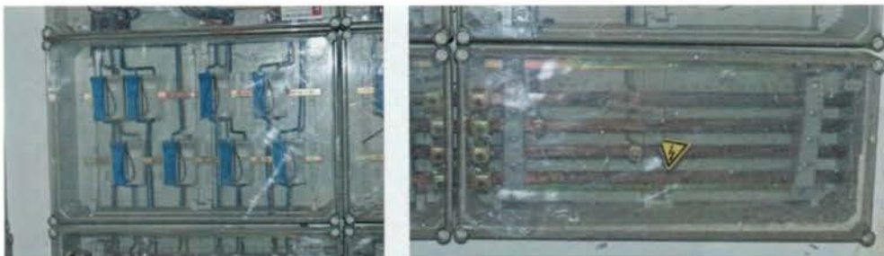
Figura 6.28. Unidad funcional de embarrado general y fusibles de seguridad.
