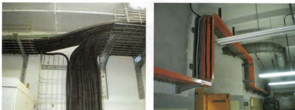
Figura 4.6. Líneas subterráneas de BT al aire en bandeja perforada.
