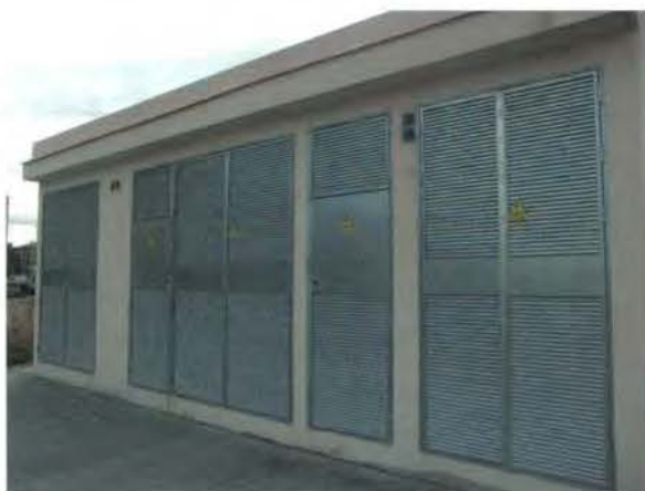
Figura 2.3. Centro de maniobra o reparto en un edificio independiente.
