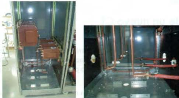
Figura 2.55. Celda de medida en un CT de abonado con fines didácticos.
