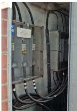
Figura 5.5. La CGP del fondo a la derecha está alimentada en paso ya que la acometida subterránea continúa hacia la caja de la izquierda.
