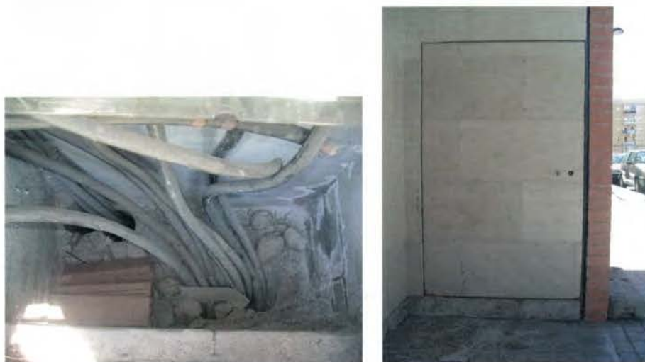
Conductos de entrada de acometidas
