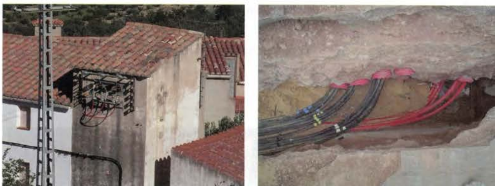
Figura 2.6. CT con acometida aérea y CT con acometida subterránea.
