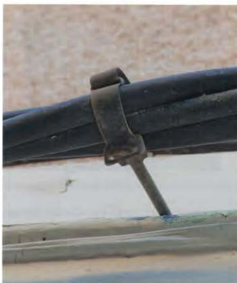
Figura 3.7. Detalle del soporte de una red posada. Se observa que existe una separación entre el cable y el muro para facilitar la circulación del aire y, consecuentemente, la refrigeración del cable.
