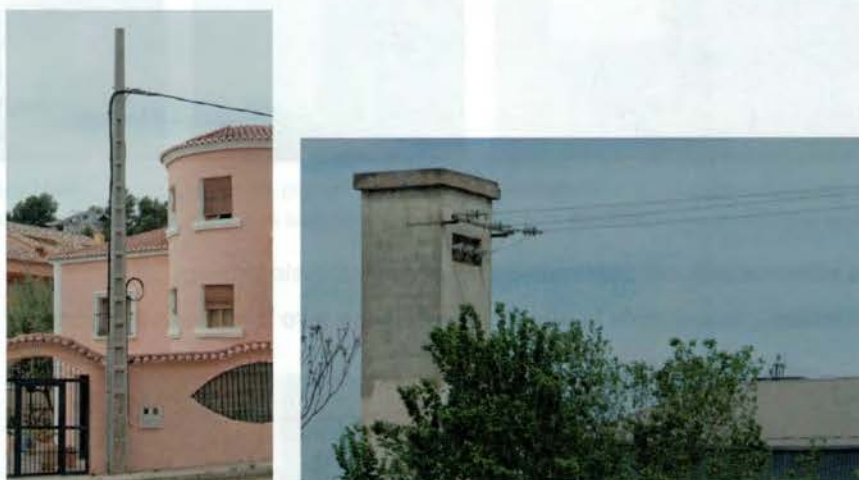
Figura 5.1. A la izquierda una acometida en baja tensión que parte de una red trenzada con conductores aislados; a la derecha una acometida en alta tensión con conductores desnudos que va a parar a un centro de transformación propiedad del abonado.
