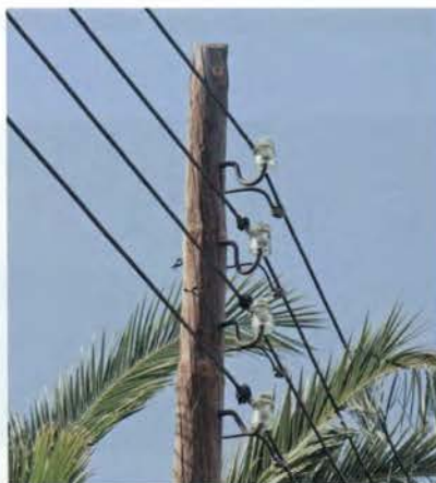
Figura 3.6. Línea aérea de BT con cable desnudo y aisladores de vidrio.
