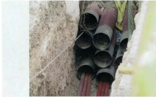
Figura 4.2. Línea de distribución subterránea en canalizaciones entubadas.
